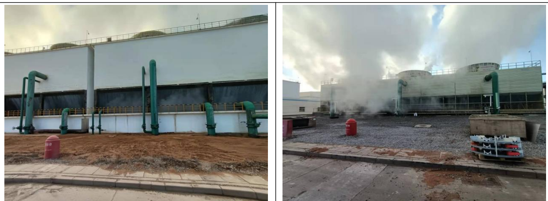
循环冷却水系统
