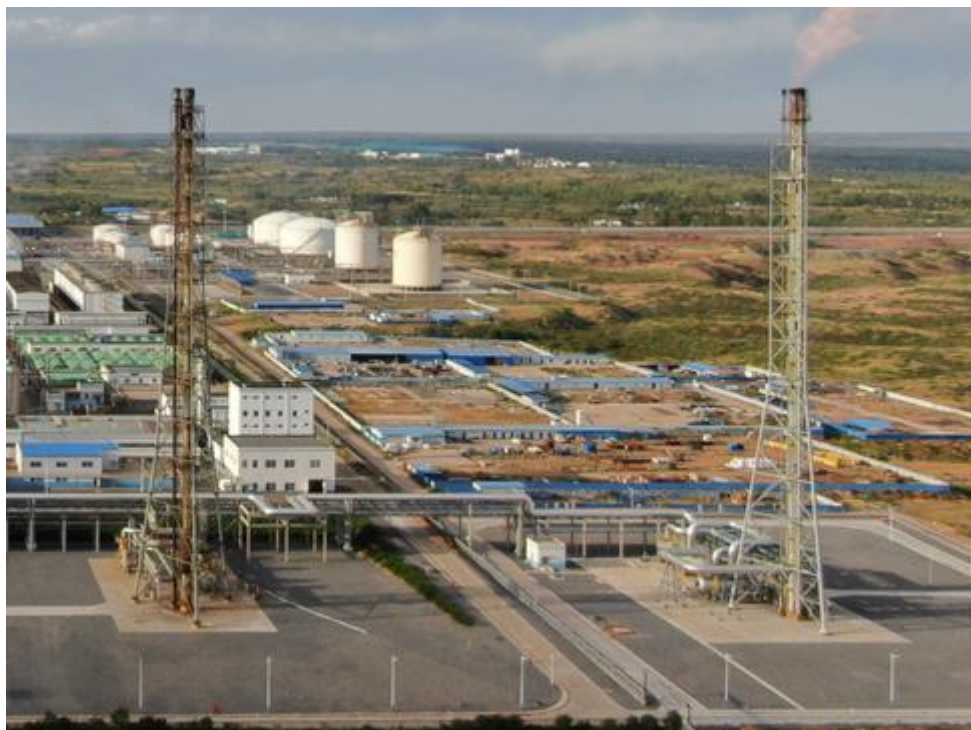
火炬系统 (右侧为本项目新建火炬系统)
