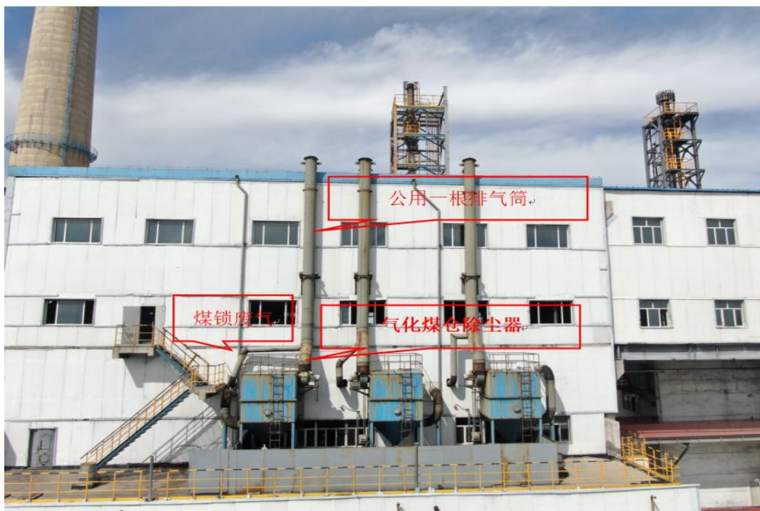
煤仓除尘器与煤锁废气共用一根排气筒
